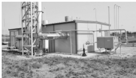
Примерно так выглядит блочно-модульная котельная.
